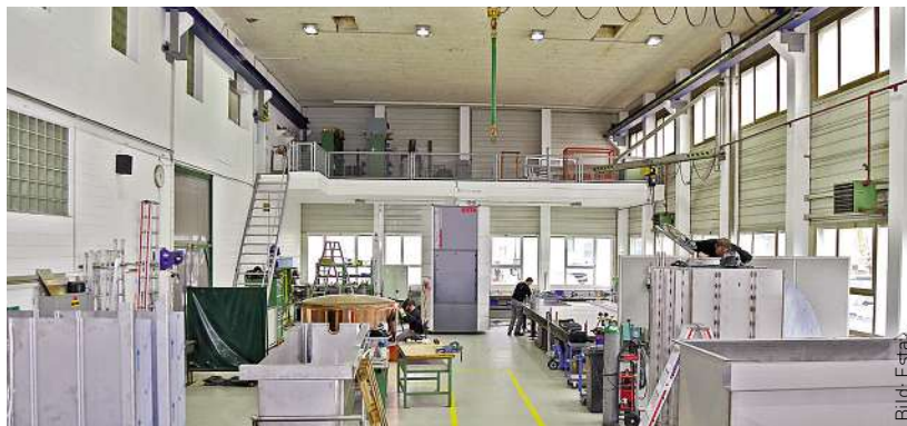
In der Schlosserei saugt der Turm im Radius bis 15 m die verunreinigte Luft auf knapp 4 m Höhe an.
